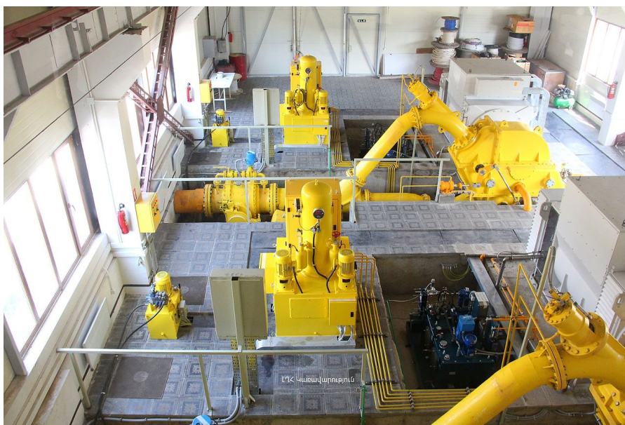
Рисунок 1. Машинное оборудование МГЭС «Трги-1», Мартакертский район, Республика Арцах
